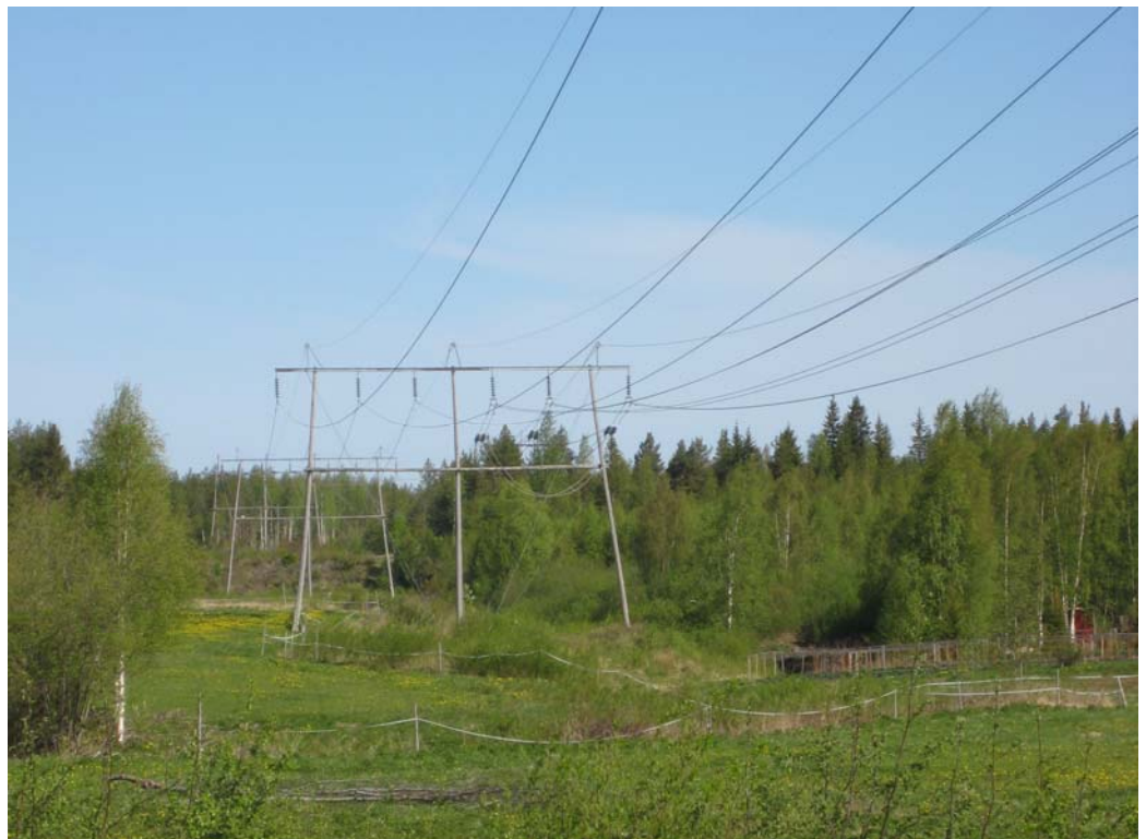
110 kV voimajohto Paakkolanojan kohdalla.
